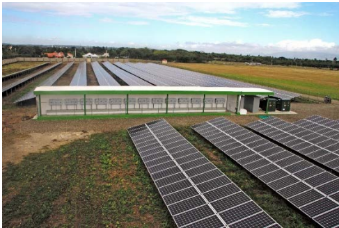
Energía solar en Aeropuerto del Cibao
