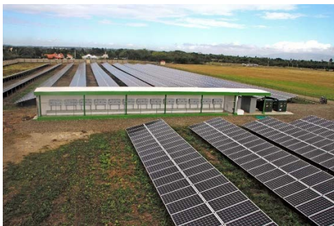
Energía solar en Aeropuerto del Cibao
