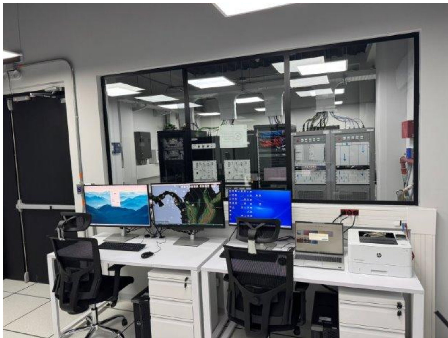
Fotografía. Sala técnica
