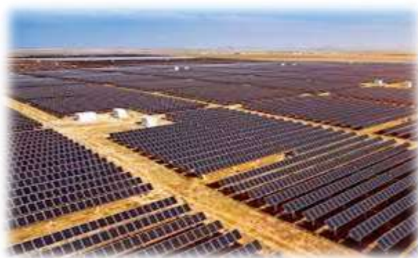
Figure 15 : Centrale solaire d'Ambatolampy
