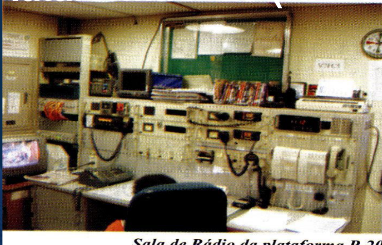
Sala de Rádio da plataforma P-20
