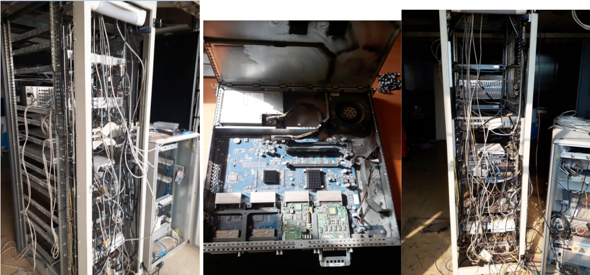
Racks en instalaciones del CNA y equipos sobre los cuales se hicieron mantenimientos
