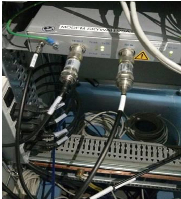
Esta imagen muestra dos DC Blocks en Skywan B
