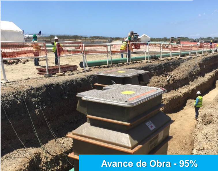
B/.12,8M Sistema de Hidrantes (fase 1.1)
