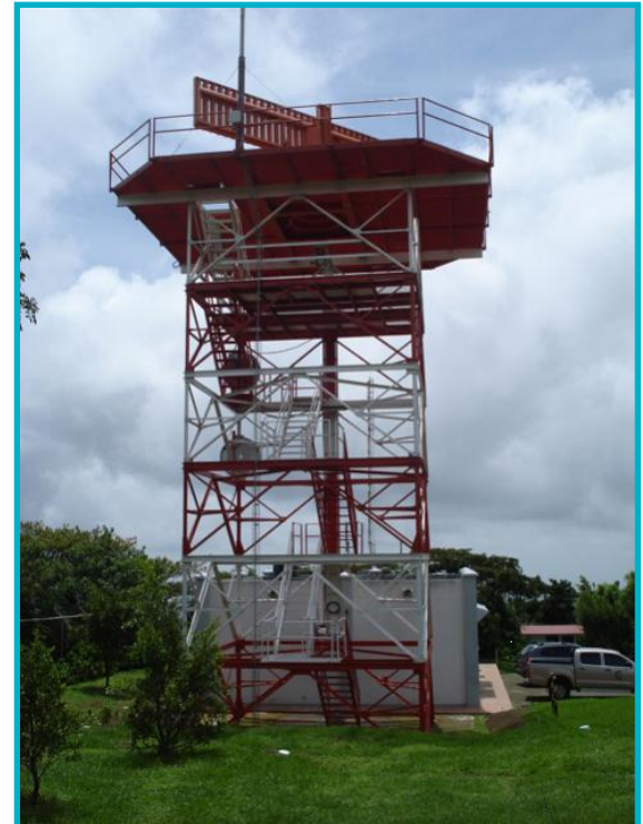
Sistema Radar: 10.000 W
