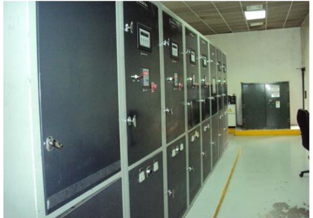
Cuarto de Reguladores
