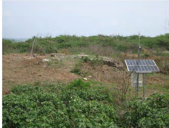
Estación GNSS/MET Galerazamba, Bolívar. Proyectos COCONET-GEORED, 2012 UNAVCO/NSF – Servicio Geológico Colombiano
