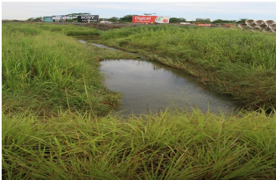
Pozo de drenaje con vegetación
