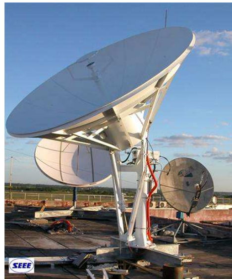
VSAT Antena Buenos Aires
