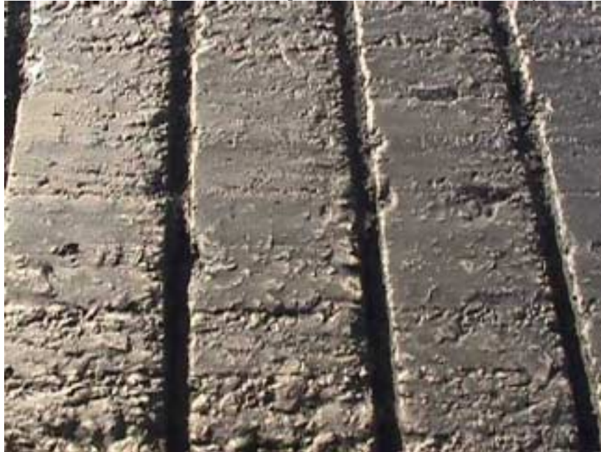
Ranurado en una pista del Aeropuerto MIAMI (concreto asfáltico)
