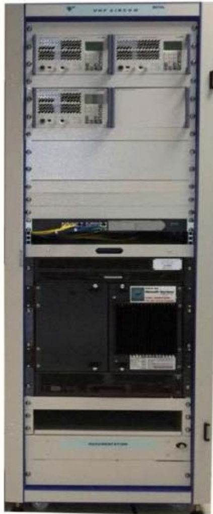
Figura 5: Ejemplo de Rack VHF Data Link
