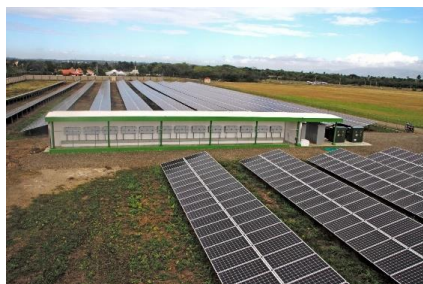
Energía solar en Aeropuerto del Cibao
