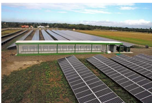
Energía solar en Aeropuerto del Cibao
